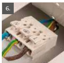
Ñ/ Conexión eléctrica
